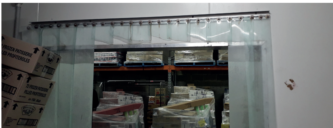
Lameller skæres væk af medarbejdere med henblik på nem adgang, men det medfører, at der ikke er nogen termisk barriere
